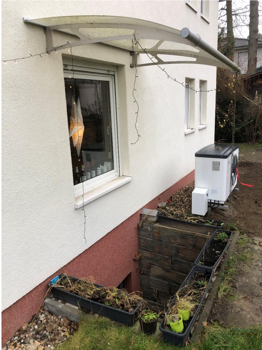
Bild 18: Lichtschacht (Gästezimmer Keller), Wärmepumpe (2023)
