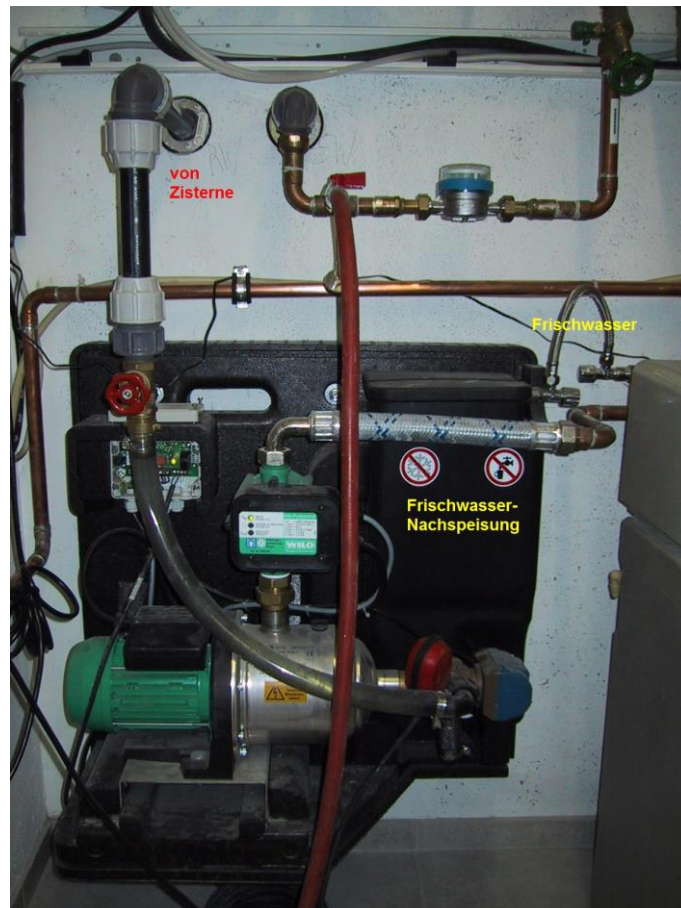
Bild 44: Hauswasseranlage für Regenwassernutzung (KG)
